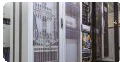
Sala de servidores
